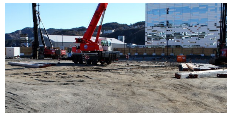
FLATT TERRENG: Slik ser det ut på rådhusområdet mot slutten av april. De høye bankelydene i sentrum stammer fra maskinene som slår fundamenteringspelene 35 meter ned i bakken.
